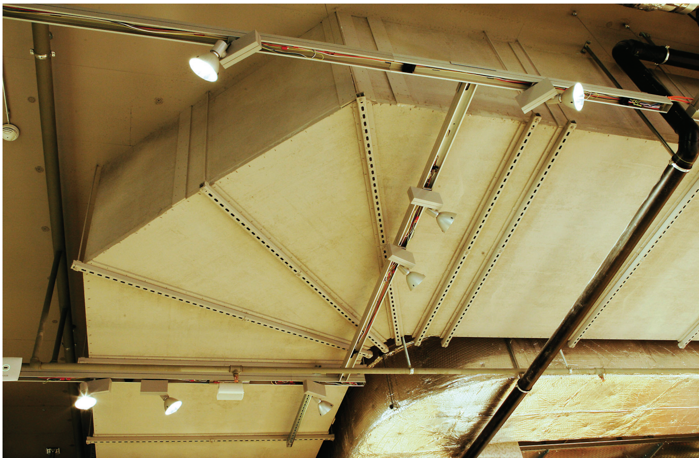
Ventilační potrubí z desek PROMATECT®
